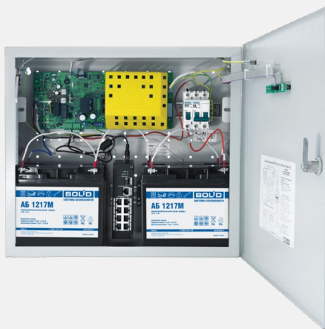
Рисунок 66. РИП-48 исп.01 с установленным внутри коммутатором SW-108
